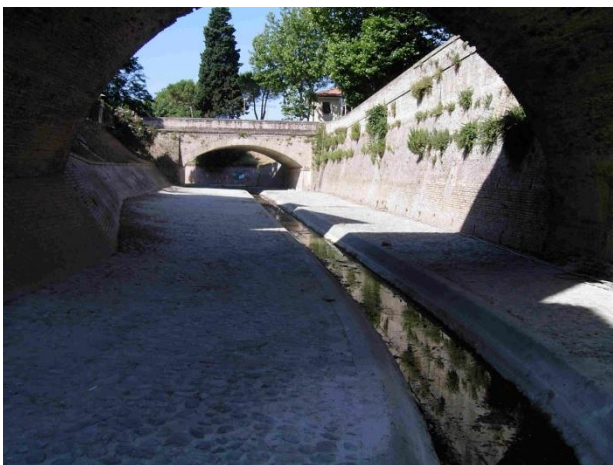
Caso 3) Rivestimenti sull'intero tratto - T.VENTENA_7
